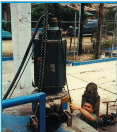
La primera de las muchas bombas de disco para el tratamiento de agua instalada en la frontera California/México.
